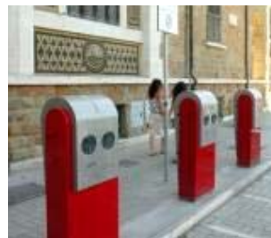
Le colonnine servono per veicoli elettrici con potenza fino a 3 kilowatt: auto, tricicli, motorini e biciclette a pedalata assistita.
